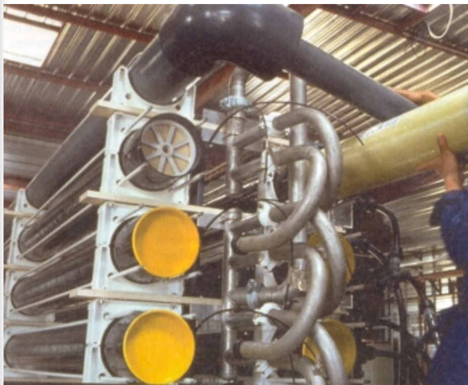
Changement d'un module de membranes de nanofiltration
