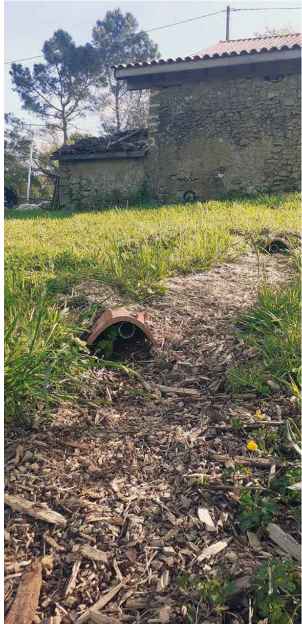
Traitement des eaux ménagères par filtres à broyat de bois
