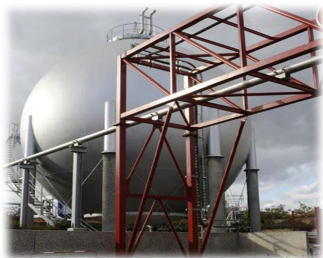
Réservoir à biogaz (STEU SIAAP Seine amont)
