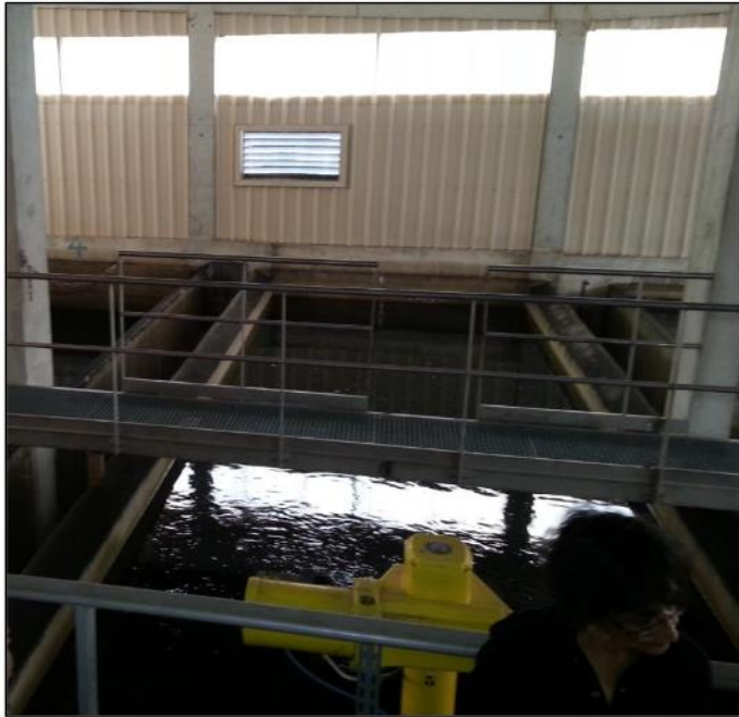
Figure 6 : Filtre en lavage
