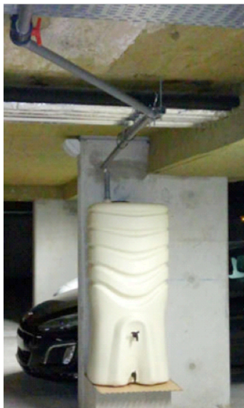
Cuve de stockage en sous-sol à l'Ecole des Ponts Paris Tech. La vanne rouge permet d'orienter les urines provenant d'urinoirs secs (situés au-dessus) soit vers l'égout soit vers la cuve.
