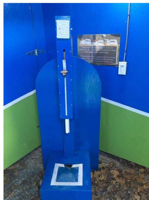
Figure 52 : Station de pompage installée à un point d'apport volontaire d'urine par le Rich Earth Institute. Crédit : Rich Earth Institute
