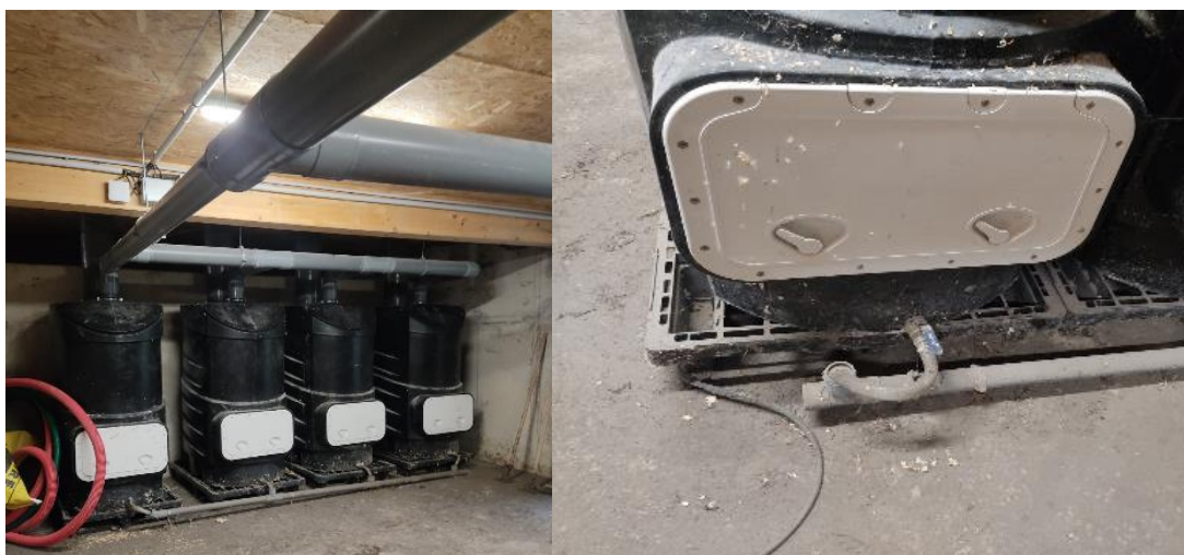
Figure 11. Cuve de compostage des matières fécales et tuyaux d'acheminement du lixiviat vers les égouts, Centre de Loisirs Jacques Chirac - Rosny-sous-Bois. (Crédit : Kelly CAN)
