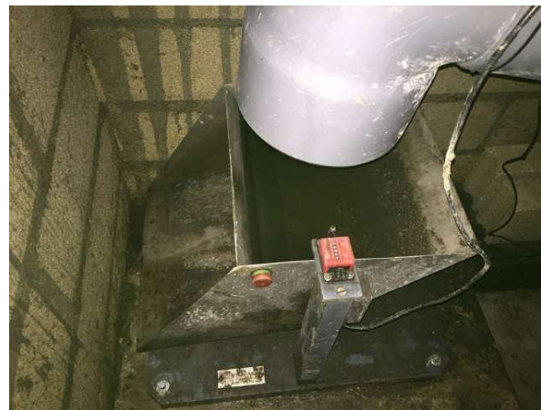
Figure 39 : Auget basculant du regard des eaux brutes
