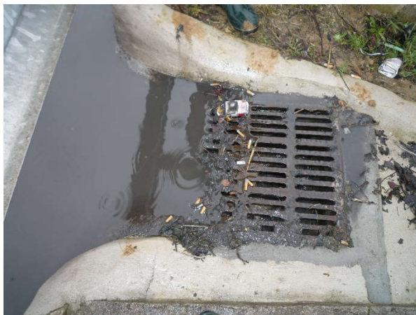
Figure 38 : Avaloir du regard des eaux brutes
